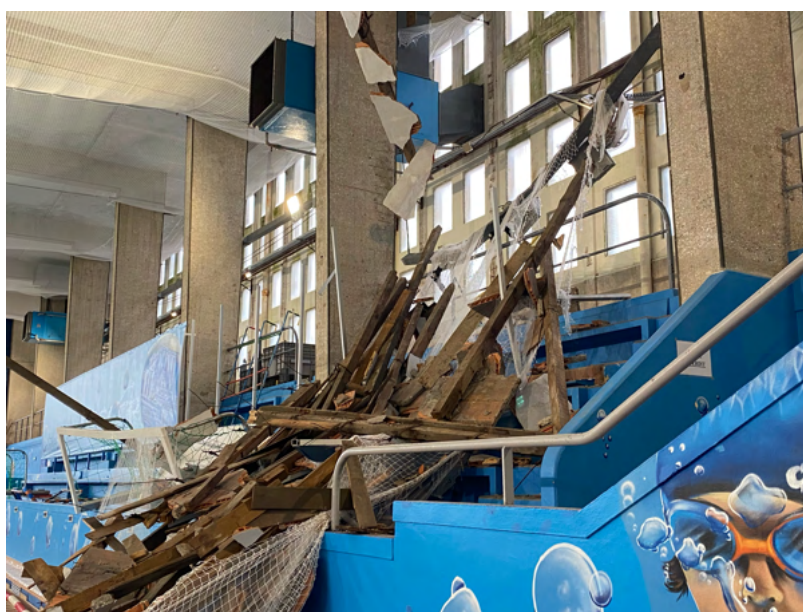
Aperçu de la structure effondrée du faux-plafond
