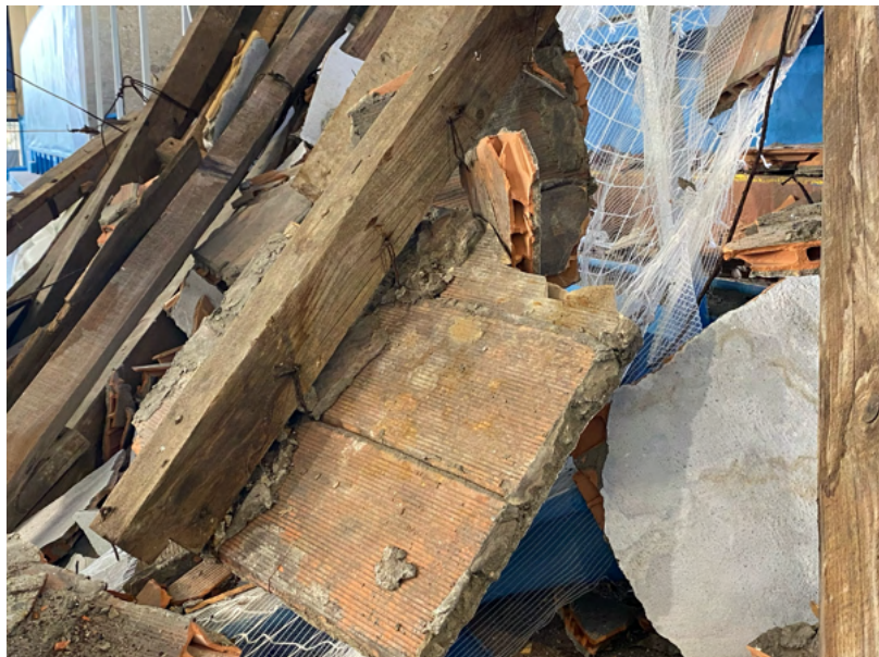
Aperçu de la structure effondrée du faux-plafond
