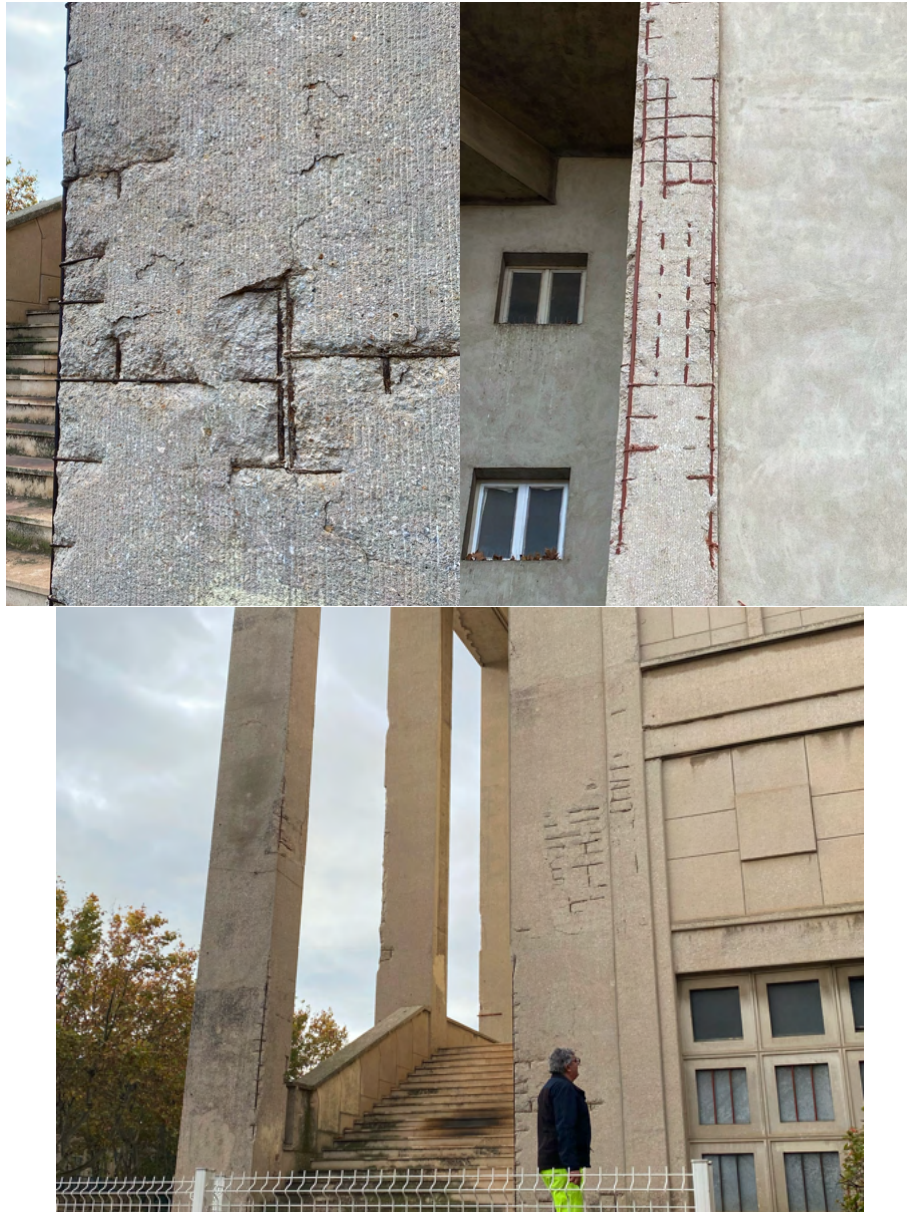
Phénomène de carbonatation du béton visible sur l'ensemble du bâtiment
