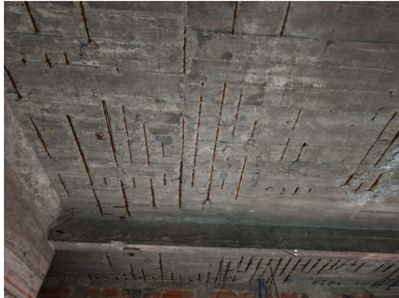
Aperçu de l'état de dégradation de la dalle en béton constituant la toiture terrasse de l'aile Ouest
