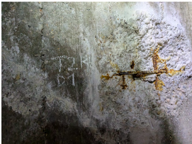
Début de corrosion des aciers de la dalle béton et épaufrures
