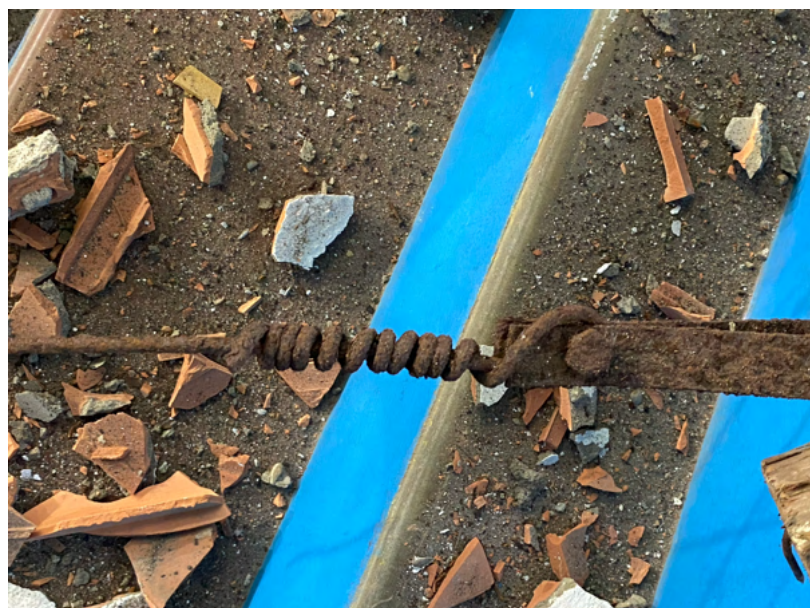
Oxydation importante des suspentes principales de la structure de faux-plafond
