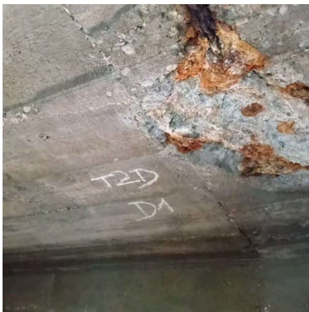
Début de corrosion des aciers de la dalle béton et épaufrures
