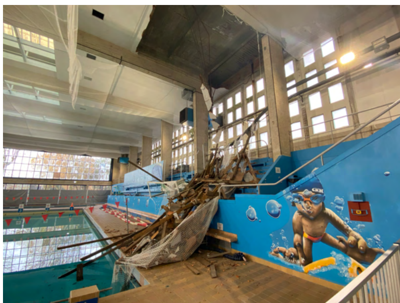
Effondrement partiel du faux-plafond au droit des gradins
