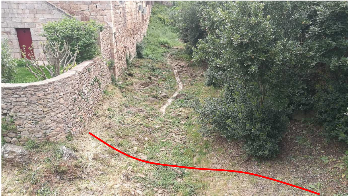
Figure 26 : Traversée du ruisseau – canalisation enterrée.
