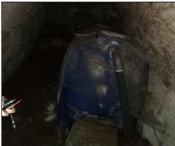
Fosse toutes eaux située sous l'abbaye Système d'assainissement 2
