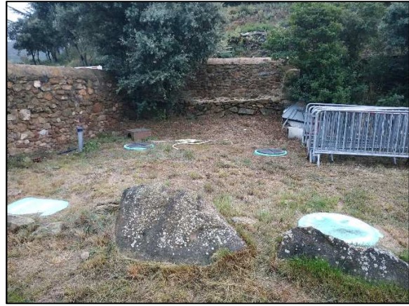
Fosse toutes eaux du système d'assainissement 1
