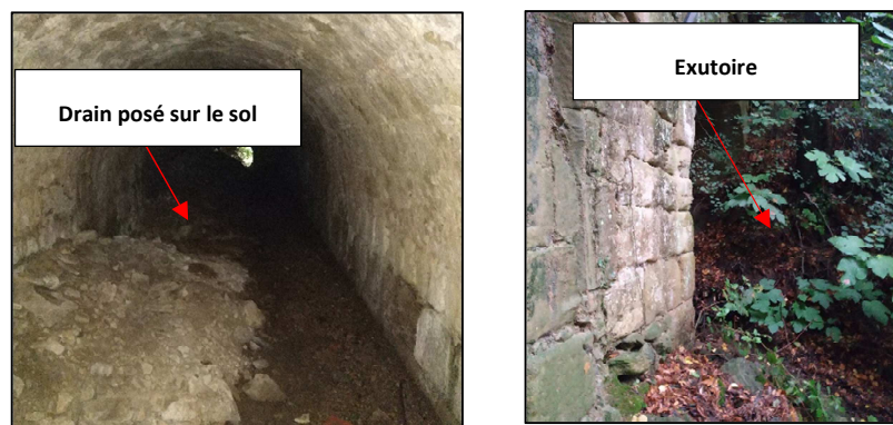
Figure 9 : Photographies de l'exutoire du drain du système d'assainissement de l'Abbaye
