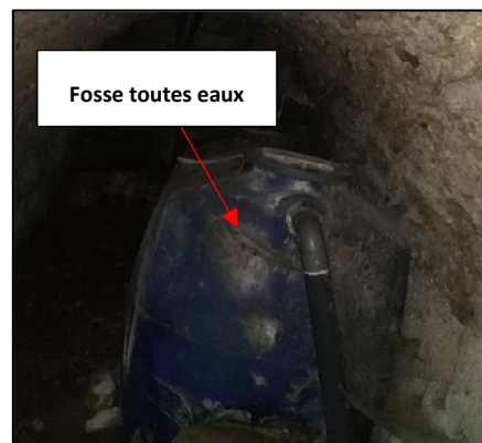
Figure 8 : Photographie de la fosse toutes eaux située sous l'Abbaye de Fontfroide
