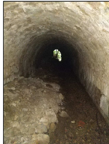
Localisation du drain d'épandage posé à même le sol – Système d'assainissement 2
